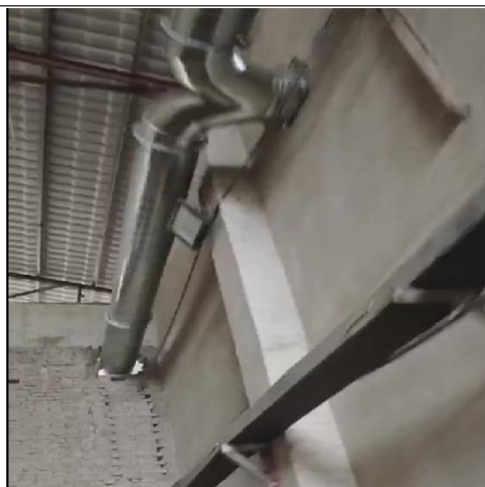
废气收集管道
