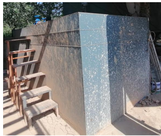
压滤废水收集池
