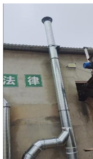
破碎筛分排气筒
